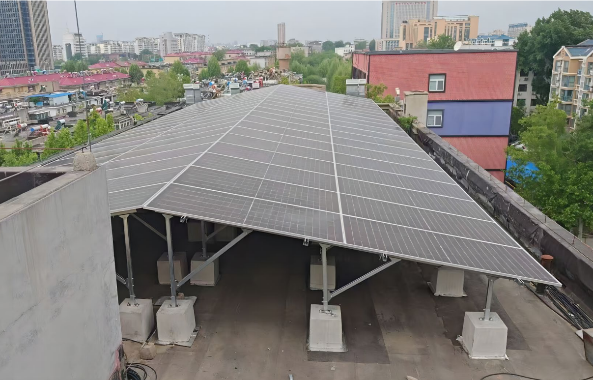
济南北城医院分布式光伏发电项目
