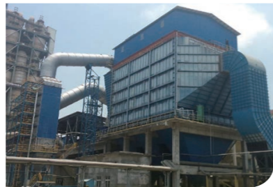
图为平南项目3#窑头袋式除尘器。华润水泥将原有电除尘器改造成排放浓度更低、运行更稳定的袋式除尘器，改造后收尘效率可达99.99%，颗粒物的排放浓度优于GB4915-2013标准，有效地降低了废气中颗粒物的排放。
